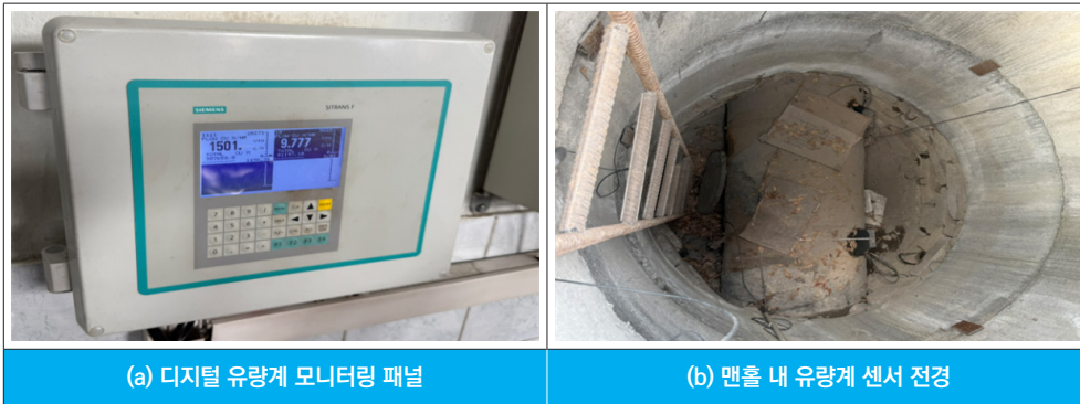
[그림 5-2] 디지털 유량 및 설치 전경
